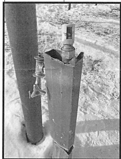
破損した水道
